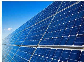
『太陽光発電設備』
