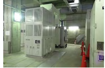
変電所機器・変圧整流設備
