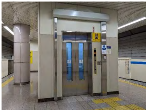
駅構内エレベーター (中田駅)
