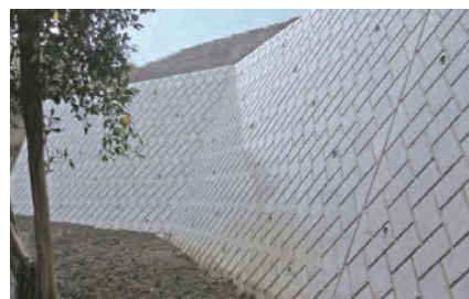
危険な崖の改善例
