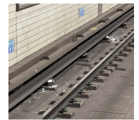
損傷した碼子
