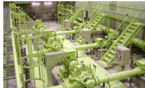
配水ポンプ (VVF制御方式)
