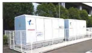
【自立型水素燃料電池システム】
