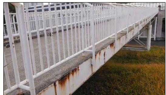
【仮設デッキの劣化状況】
