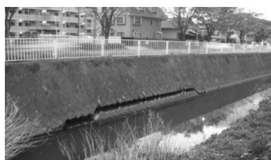
河川護岸の崩壊
