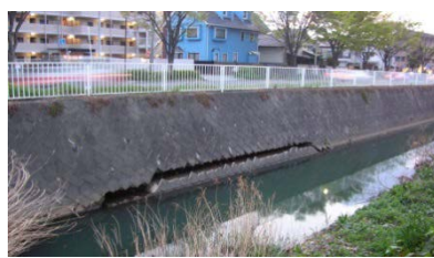
河川護岸の崩壊
