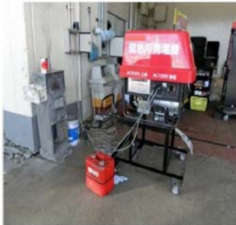
①平成30年北海道胆振東部地震の際に自家発電設備を稼働させて給油を続けたSS
