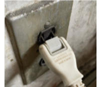
差し込みが甘い 状態のプラグ
