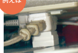
たこ足配線、ホコリが たまっているコンセント
