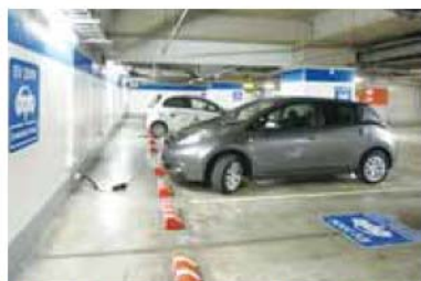
横浜ランドマークタワーの充電スタンド Charging stand at the Landmark Tower Yokohama
