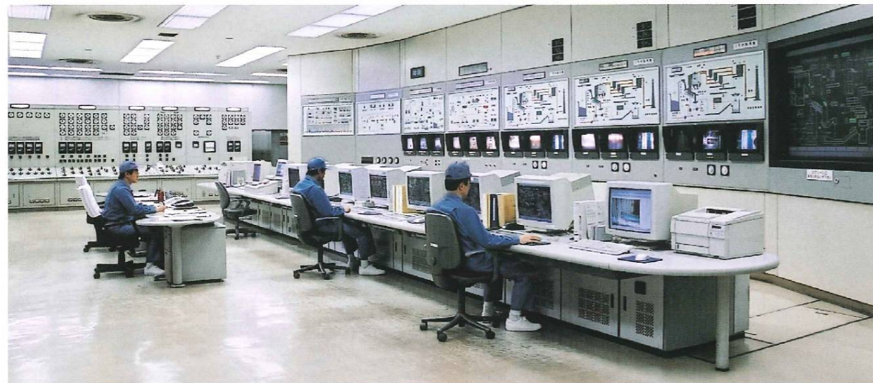
中央管制室/Central control room
