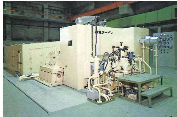
蒸気タービン発電機/Steam turbine generator
