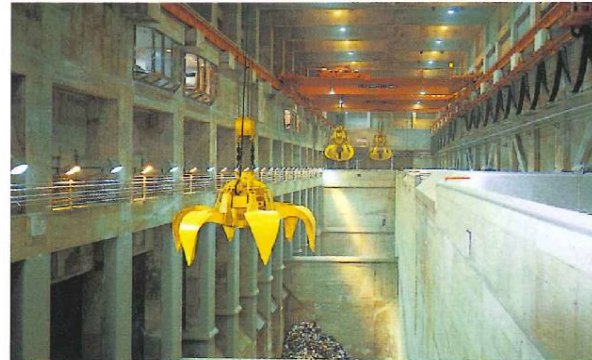
ごみピット/Refuse pit
