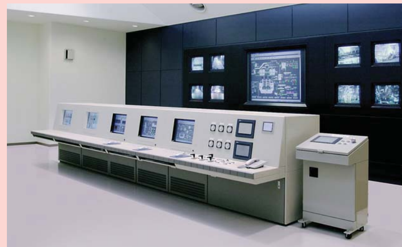
管制室 Control room
