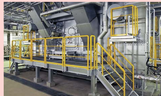
焼却炉本体 Incinerator
