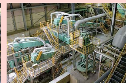
焼却灰搬送コンベア Incineration ash conveyor
