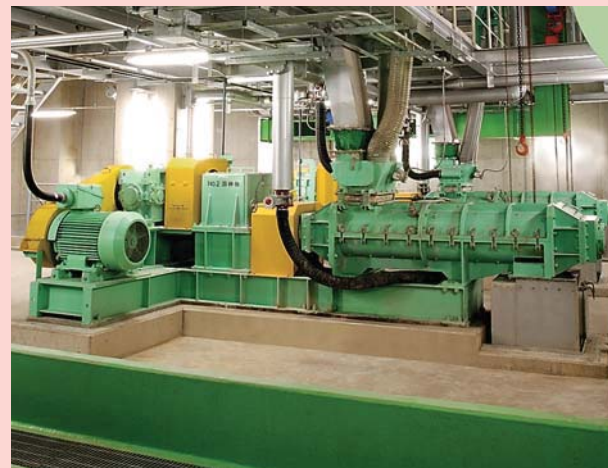
飛灰処理設備 二軸混練機 Fly ash treatment system 2-shaft solidifier
