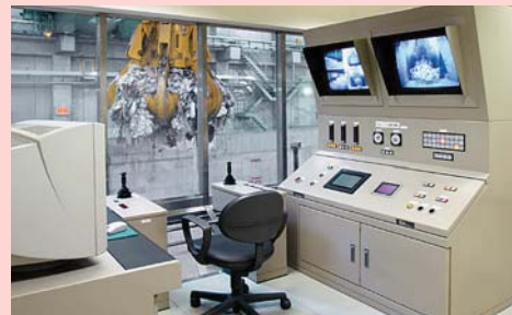
ごみクレーン操作室 Refuse crane operating room
