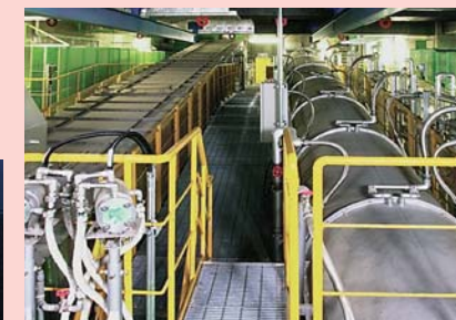
メタル/スラグコンベア Metal & Slag conveyor
