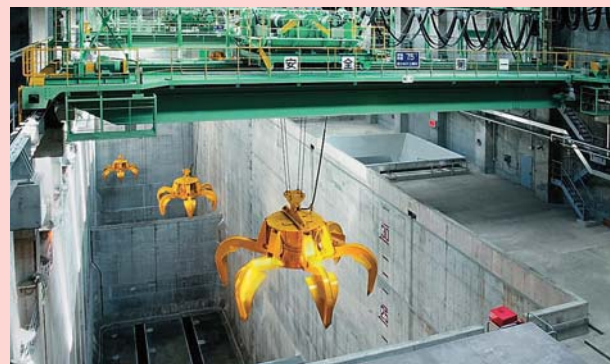
ごみピット/ごみクレーン Refuse pit & refuse crane
