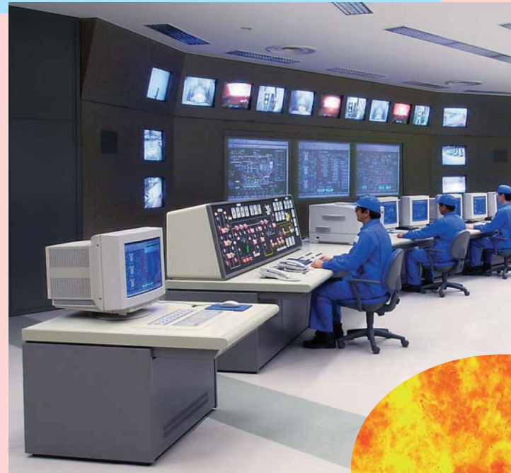
中央管制室 Central control room
