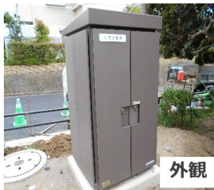
水道計測設備の写真
