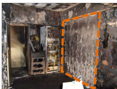
火災発生現場
