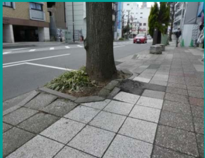
【保土ヶ谷駅西口交通広場～イコットハウス間】 ●歩道の平坦性の改善 ◆舗装の改修
