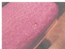
【ホール座席/座面の破損・汚損】
