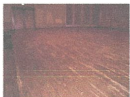
【ホール舞台床面の劣化】
