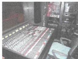
【音響調整卓/第1期工事完了】
