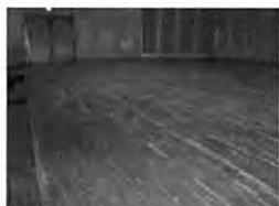
【ホール舞台床面の劣化】
