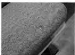
【ホール座席/座面の破損・汚損】
