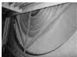
【空調設備/著しい経年劣化】
