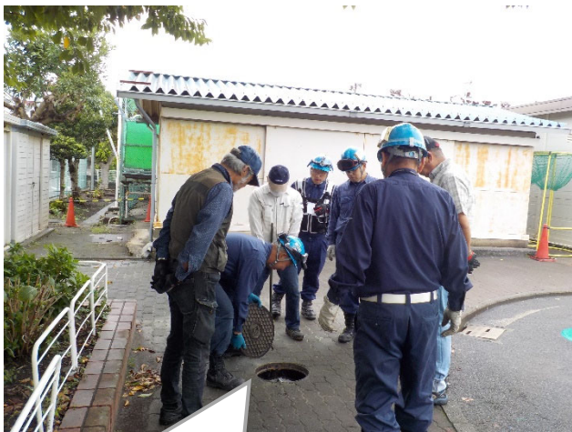
ハマッコトイレの設置場所の確認と貯留弁開閉治具の使用方法的説明
