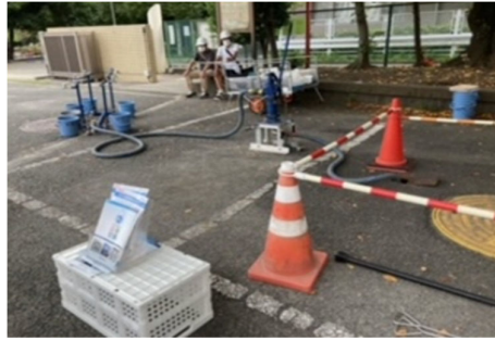
地下給水タンクからの取水 （下田小）
