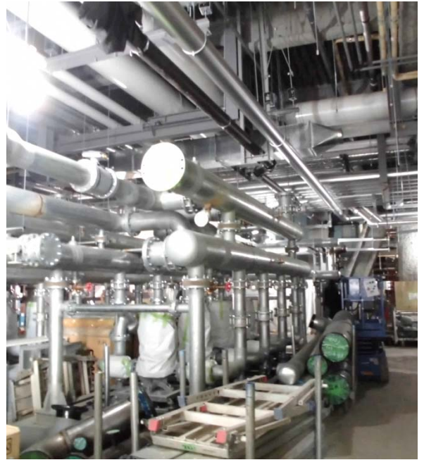
行政棟 4階機械室
