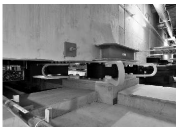
免震・制震装置
