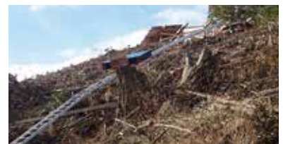
山の斜面へメガソーラー設置にて使用
