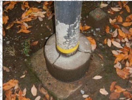
老朽化(柱・基礎)
