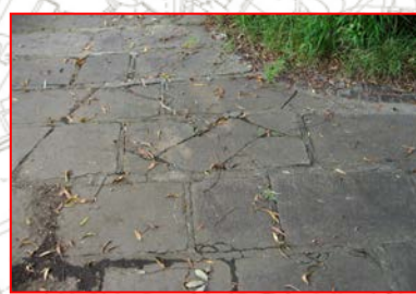
白河石舗装 根上りで石が割れている。
