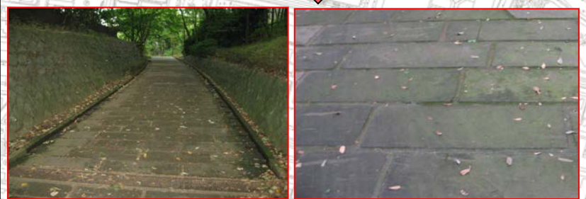
白河石舗装 (目地埋めあり) 日陰で湿度があるため苔が生えてすべりやすい。
