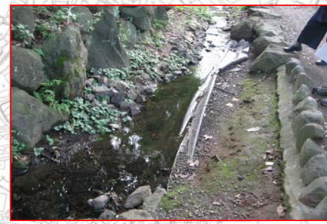
護岸石積 護岸の石積みの基礎がはみ出している。
