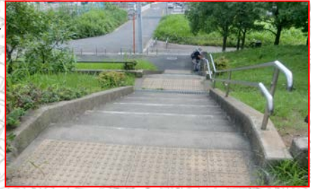
手すり 階段の手すりが基準に適合していない。(片側しかない)
