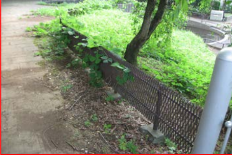
転落防止柵 高さが低く、突起がある
