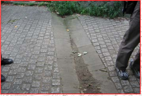
段差 V型横断溝が段差になっている
