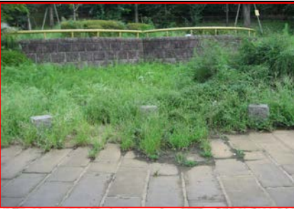
土の堆積 斜面上部から土が流れ堆積している
