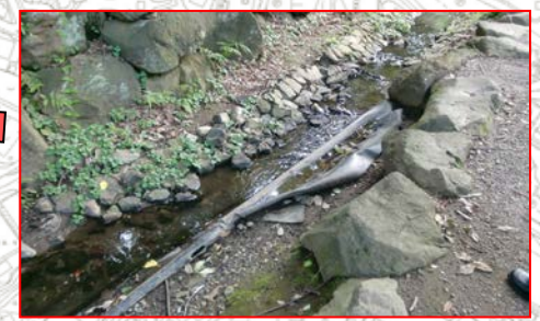
防水シート 護岸の石積みはずれて、防水シートが露出している。
