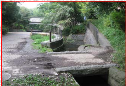
土の堆積 斜面から土が流れて堆積している
