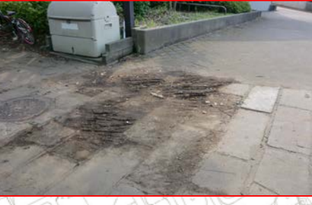
土の堆積、水たまり 石張り舗装がくぼんで、水たまりができ土が堆積している
