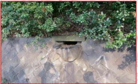
壁泉 上流部分が詰まって水が出ていない。
