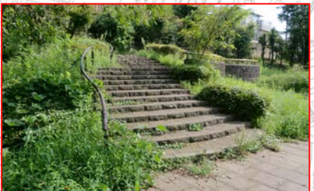
手すり、誘導用ブロック 階段の手すり、誘導用ブロックが基準に適合していない。
