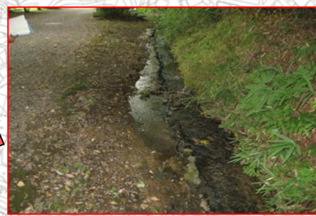
護岸の崩れ 水流で土が削れて護岸が崩れている。
