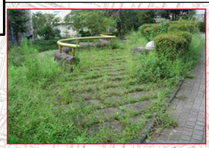
白河石舗装 (目地埋めなし) 目地が段差になっている。
