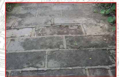
白河石舗装 石の段差や、目地がひび割れがある。
