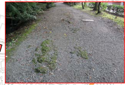
土舗装 コンクリート塊が突出している。
