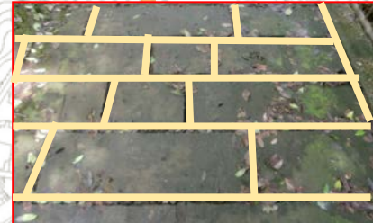
白河石舗装 (目地埋めしていない箇所) 目地にモルタルを埋め、段差を解消する。
