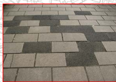
赤御影石舗装 アスファルトで部分補修している。
