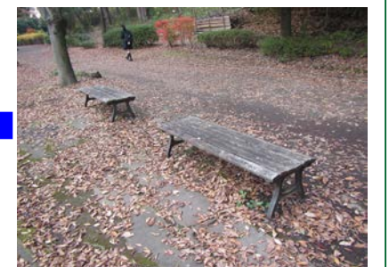
現況のベンチ 座板の老朽がみられるため、ヒノキ材で更新します。
