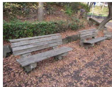
現況のベンチ 座板の老朽がみられるため、ヒノキ材で更新します。
