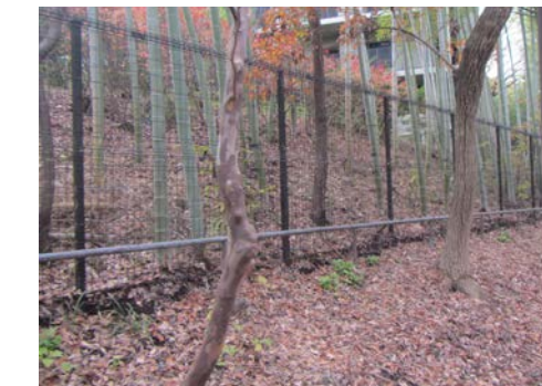
民地との境界を示す1段パイプ柵 破損しているものは修繕し、それ以外 のものは塗装を塗り直します。 また、民地に越境している樹木は剪定を 行います。
