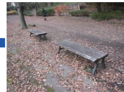
現況のベンチ 座板の老朽がみられるため、ヒノキ材で更新します。
