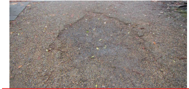
現況：表面がはがれ、段差ができている。
