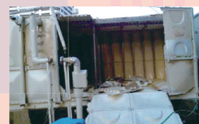
◀受水槽が壊れたマンション (平成23年東日本大震災) 出典:東日本大震災アーカイブ宮 城[仙台市]「震災とマンション」 /提供者:一般社団法人宮城県マ ンション管理士会
