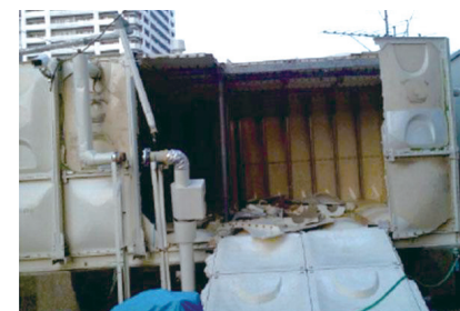
受水槽が壊れたマンション (平成23年東日本大震災)
