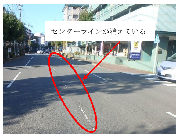
写真2 センターラインの劣化
