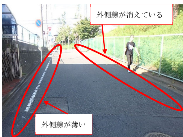
写真1 外側線の劣化
