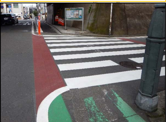
⑤横断歩道拡幅(警察)+横断歩道 サイドにベンガラ塗装(土木)
