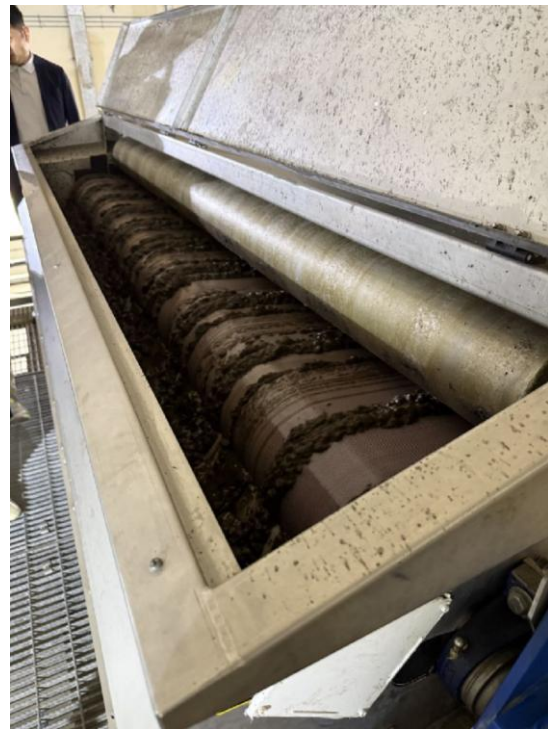
脱水後の汚泥
