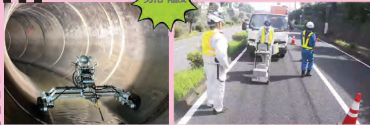
インフラの劣化や、陥没につながる路面下空洞を見逃さない
