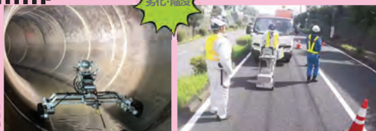
インフラの劣化や、陥没につながる路面下空洞を見逃さない
