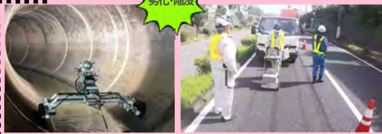
インフラの劣化や、陥没につながる路面下空洞を見逃さない
