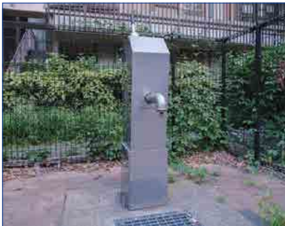
新横浜第一公園災害用井戸
