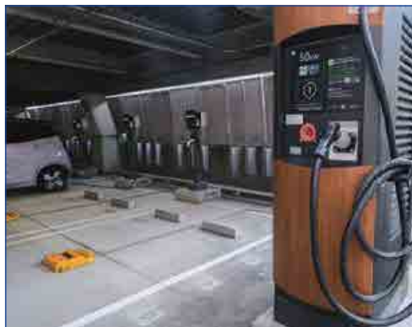
EV 充電スタンド
