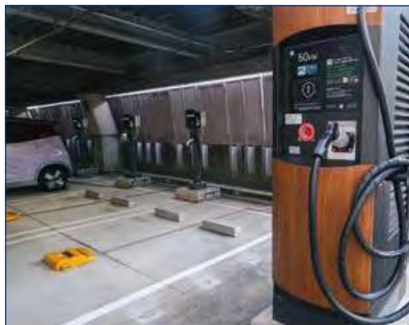
EV充電スタンド
