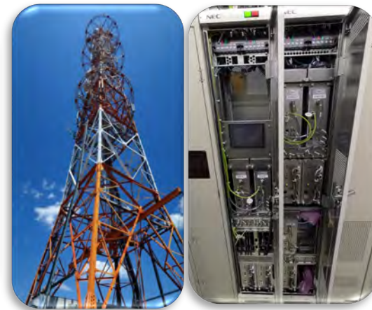
《電波塔/無線装置本体》
