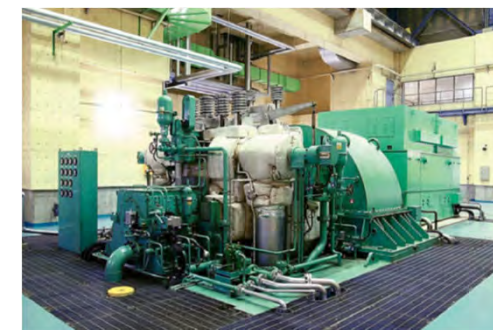
改修を予定する蒸気タービン
