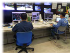
焼却工場管制室の様子
