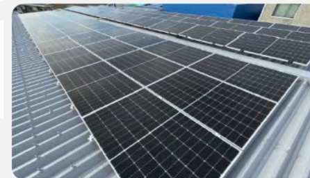
太陽光発電設備
