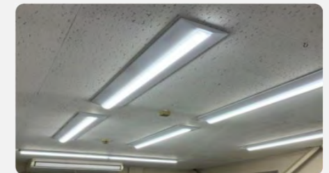
LED照明設備
