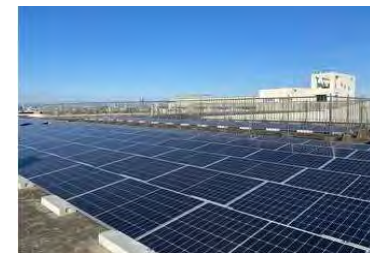
太陽光発電設備
