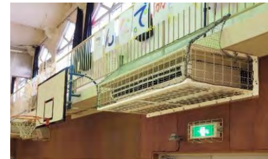
体育館空調設備
