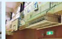
体育館空調設備
