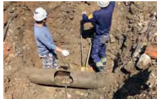
鋳鉄管の破損事故
