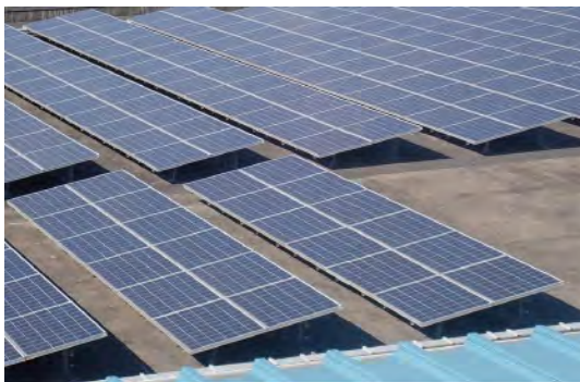
太陽光発電設備(川井浄水場)
