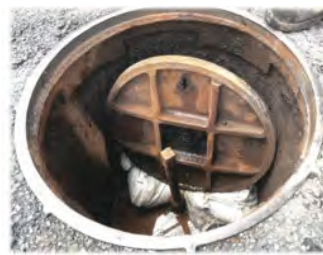
附属設備の老朽化事例 (マンホール鉄蓋の脱落)
