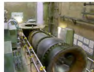
ポンプ 再整備工事前
