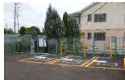
E V充電設備付き 時間貸し駐車場（瀬谷区）
