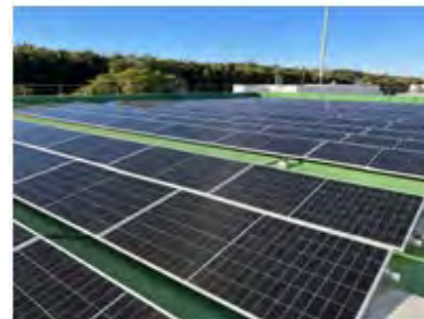
令和6年度導入太陽光発電設備 （金沢水再生センター）
