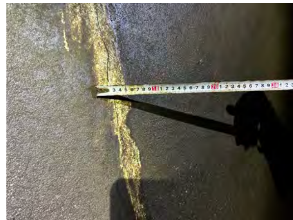
下水道管内の状況(クラックの一例)
