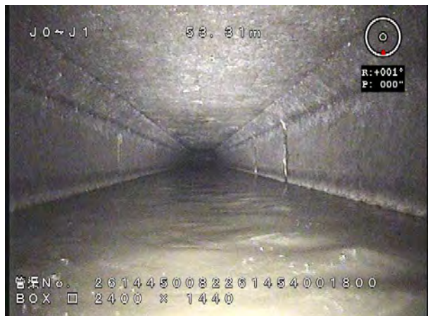
下水道管内の状況(腐食の一例)
