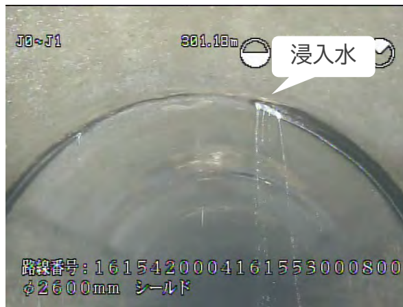
下水道管内の状況(浸入水の一部)
