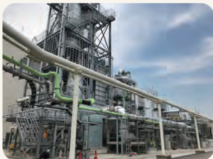
汚泥燃料化施設
