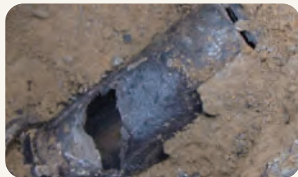
破損したZパイプ
