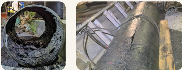
老朽化により腐食が進んだ送泥管
