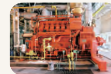
消化ガス発電
