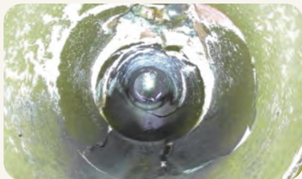
破損した陶管
