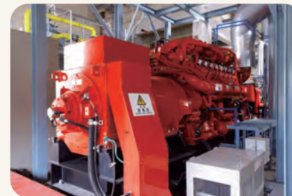
消化ガス発電設備
