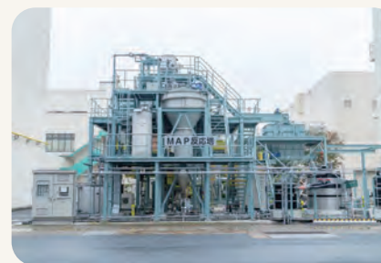
リン回収施設
