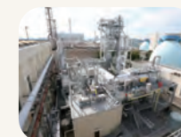
下水汚泥燃料化施設
