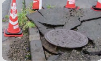
マンホール浮上被害状況
