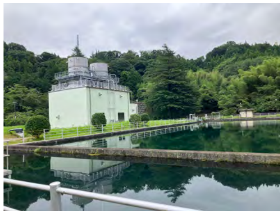
青山沈でん池 活性炭注入設備
