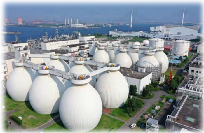
汚泥集約処理の象徴である卵形消化タンク
