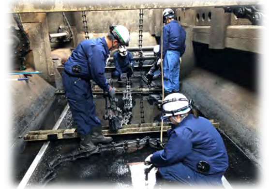
最初沈殿池設備
