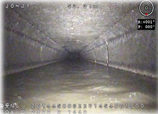
下水道管内の状況(腐食の一例)
