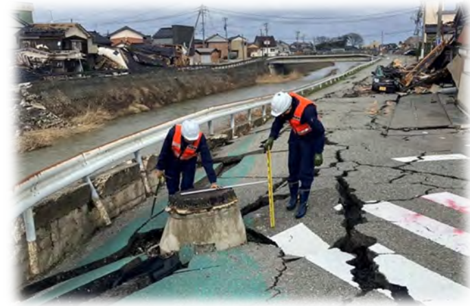
マンホール浮上の状況 (令和6年能登半島地震: 輪島市)
