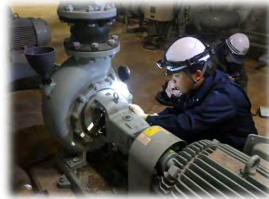
汚泥ポンプ設備
