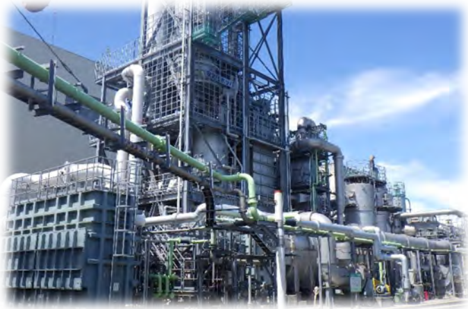
汚泥燃料化施設
