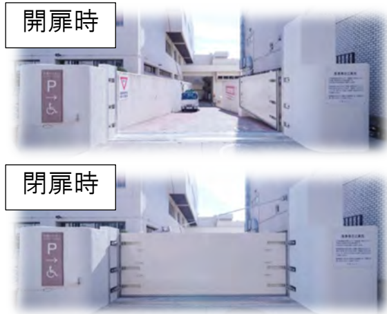
防水扉（戸塚ポンプ場）
