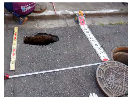
取付管破損による道路陥没
