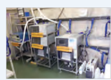
図 4-16 測定局舎内の測定機器
