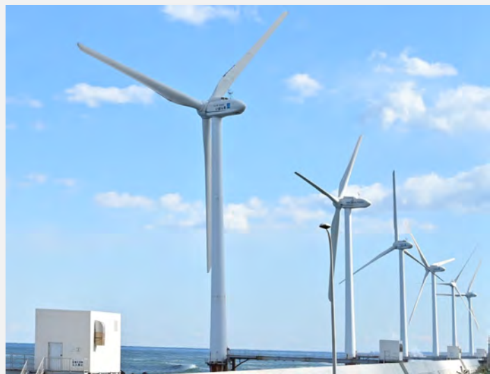
再エネ連携先の茨城県神栖市に立地する「ウィンドパワーかみす」
