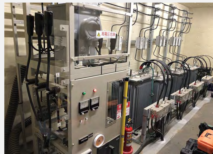
設置された高圧一括受電の受変電設備
