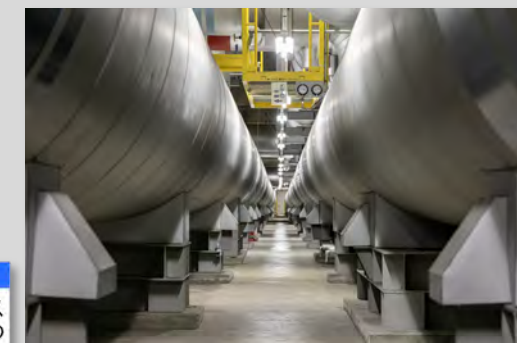
熱を供給するための導管
