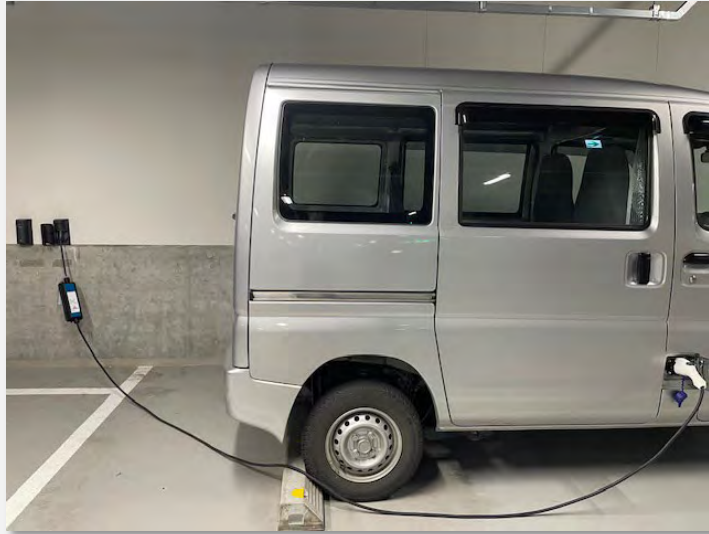
公用車駐車場に設置した充電コンセント
