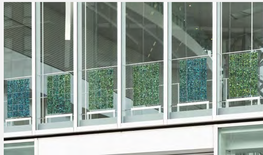
建材一体型太陽電池の設置例(7年度市庁舎アトリウムでの実証実験)
